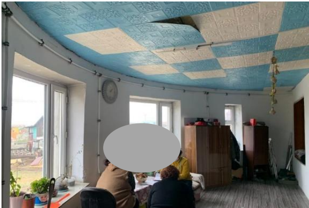
写真3 世帯No8の曲がっているところの内装
